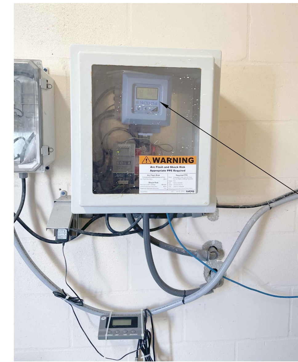
PHOTO: EXISTING FLOW TRANSMITTER SCALE: N.T.S.
